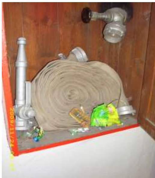
Obrázek 11 - S takovýmto hydrantem se požár hasit nedá. Preventista musí dohlížet na to, aby všechny prostředky PO byly v provozuschopném stavu.
