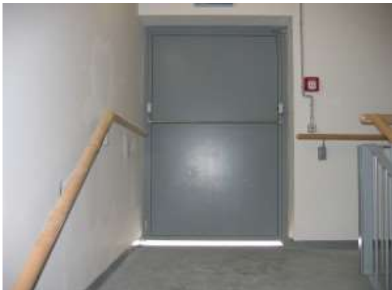
Obrázek 1 - Požární dveře vedoucí na únikové schodiště. Napravo od dveří můžeme vidět tlačítko EPS.
